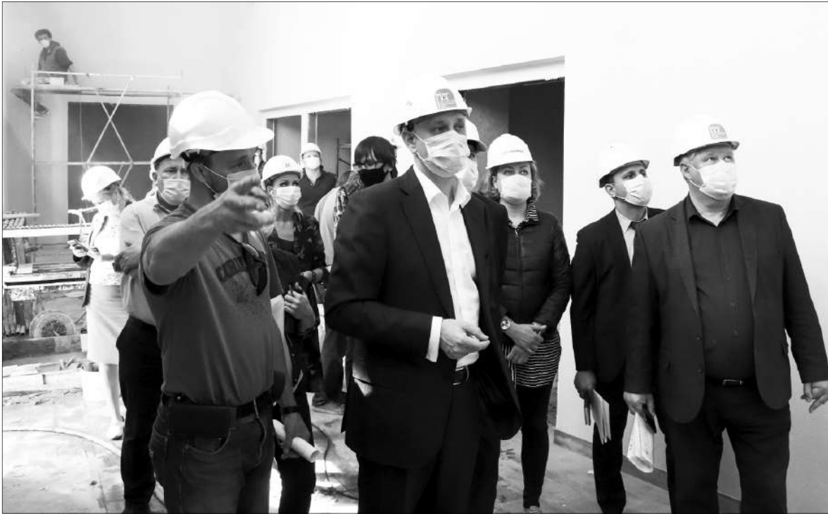
Ход работ в драматическом театре имени Пушкина проинспектировал глава города Сергей БЕРДНИКОВ
